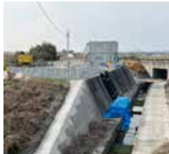
整備中の排水ポンプ
